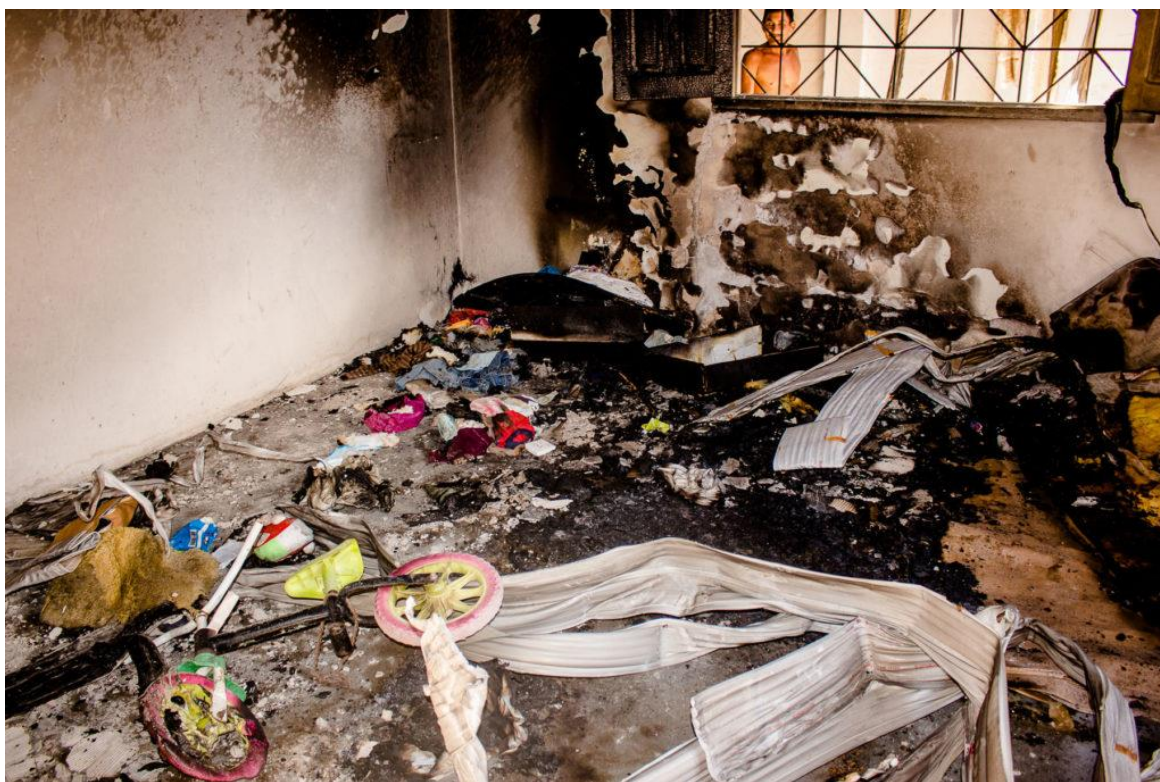
Interior da casa dos venezuelanos que foi incendiada em Boa Vista, em fevereiro (Foto: Yolanda Mêne)
